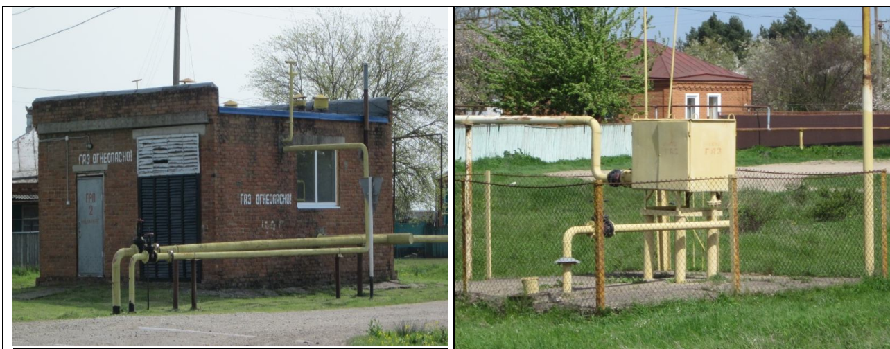
Состояние и внешний вид ГРПШ на территории аул Понежукай.
