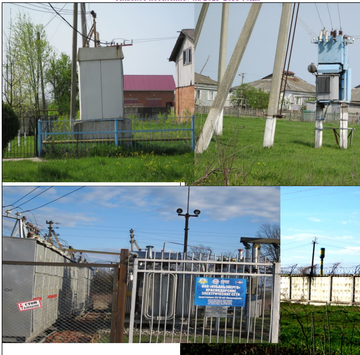
Состояние и внешний вид электросетевого хозяйства в ауле Понежукай:
